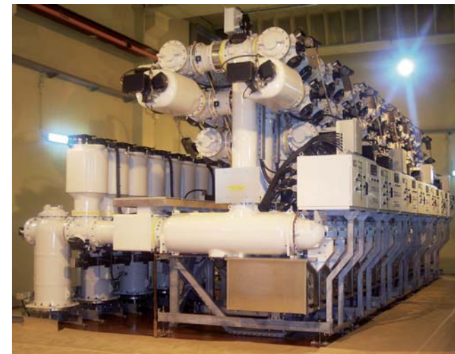
Equipos de transformación.
